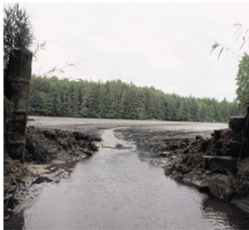
Hier war Sonntagabend noch der Damm des Schneidweihers, ehe die Wassermassen eine circa 500 Kubikmeter große Schneise in das Erdreich rissen. Bild: edo
