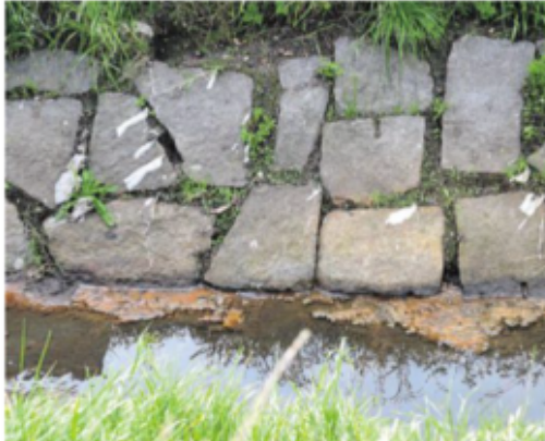
Im Spreitzbach in Hirschau schwimmen Fäkalien. Bild: roa
