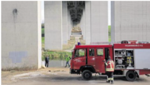
An einem Brückenpfeiler, der zur Autobahn gehört, war Diesel hinabgelaufen, der in der Vils gelandet ist. Bild: Wolfgang Steinbacher
